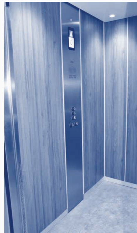
Beaupréau, Clos Saint Jean - Cabine d'ascenseur
